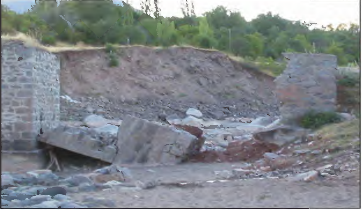
Şekil 3. Avutmuş deresinin yükselen debisi ve hızı ile yıkılan köprü (Eşekgölü mevki).
