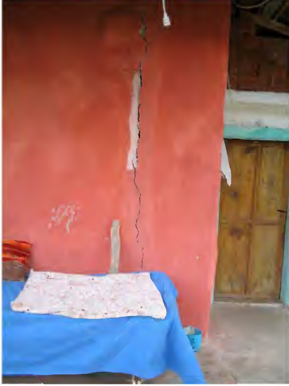
Şekil 5. Duraysızlıklardan etkilenmiş bir ev. Figure 5. A house affected from instabilities.
