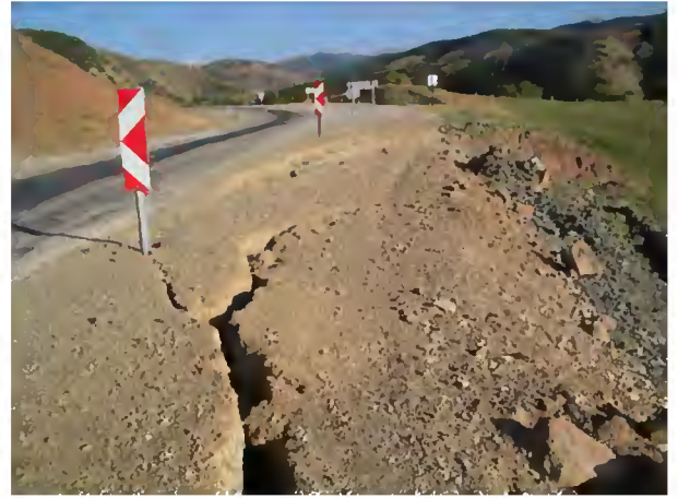
Şekil 4. Duraysızlıklardan etkilenmiş bir yol. Figure 4. A road affected from instabilities.
