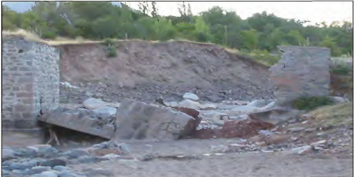
Şekil 10. Avutmuş çayının artan debisi sonucunda yıkılmış bir köprü.
